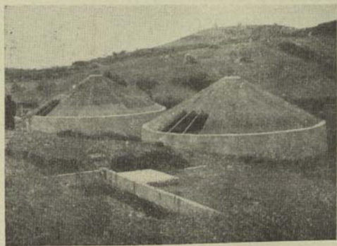
Filtros percoladores da Estação depuradora de esgotos do bairro popular da Boavista (Parque Florestal de Monsanto), com distribuidores rotativos automáticos
