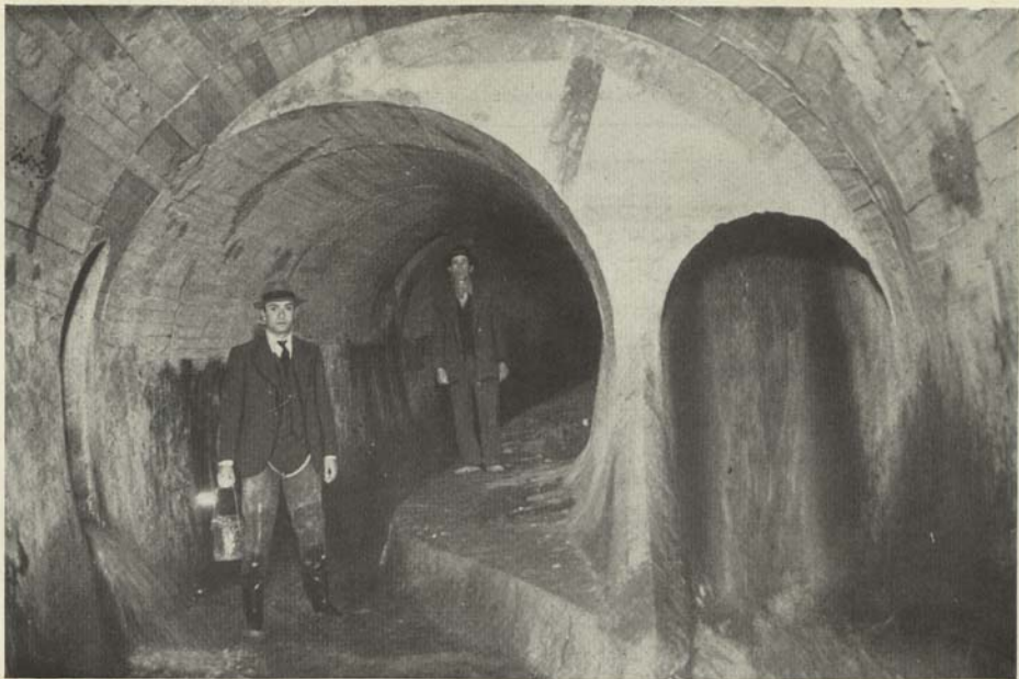
LIGAÇÃO DE 2 COLECTORES E 1 RAMAL, SOB A RUA DA PALMA, (VENDO-SE UM DOS ENGENHEIROS DA C. M. L. E UM FISCAL EM VISITA DE INSPECCÃO)
