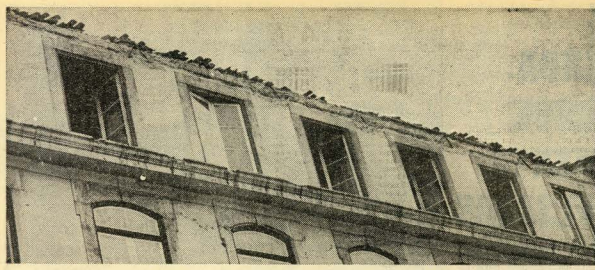
Estado em que ficou um dos prédios na Baixa pombalina
