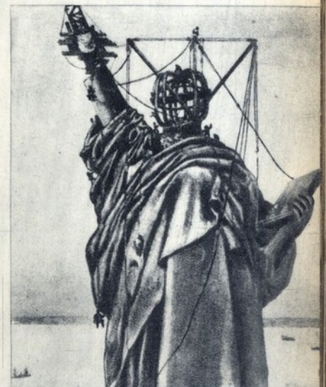
A montagem da estátua. Os operários parecem formigas nesta colossal montanha esculpida
