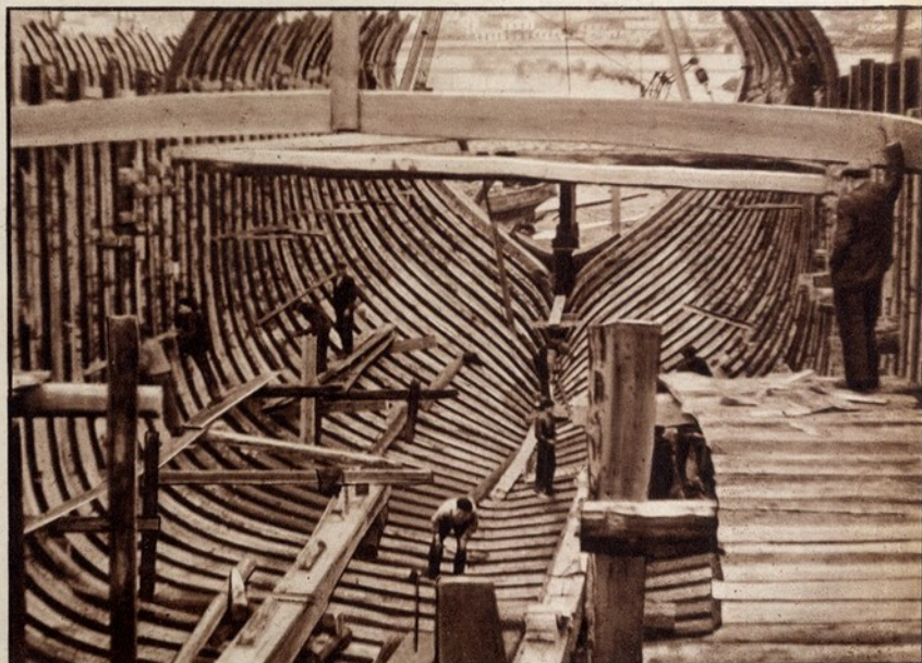
No ventre descarnado deste monstro gigantesco, os operários trabalham activamente no sólido cavername da nave
