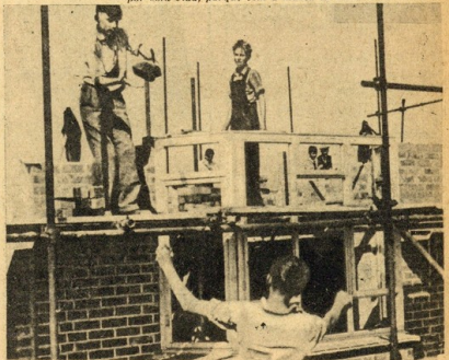
A obra começa a ser uma casa! E as paredes vão subindo com uma precisão que surpreenderá os mais experimentados construtores. Bravo, rapazes...
