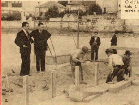
1 — As obras começaram no passado domingo no Campo da Constituição. 2 — O arquitecto Oldmiró Carneiro, a quem estão confiadas as obras, e o sócio n.º 1 do Futebol Clube do Porto trocam impressões sobre o campo
