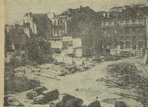
Já se vê a Mouraria do meio da rua da Palma, onde dois prédios seguidos já estão quase demolidos, deixando a velha capela do Saúde quase liberta dos edifícios que a rodeiam e cujo aparcamento vai seguir-se. Com o desaparecimento do quartelão de entre o antigo Guio e o Socorro, e as ruas da Palma e da Mouraria, cujas prédios foram já quase todas compradas pelo Camara Municipal, será possível começar a construção da Praça D. João I, que será uma das mais grandiosas da capital
