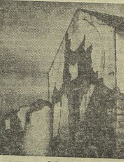
O lamentável estado actual do edifício escolar
