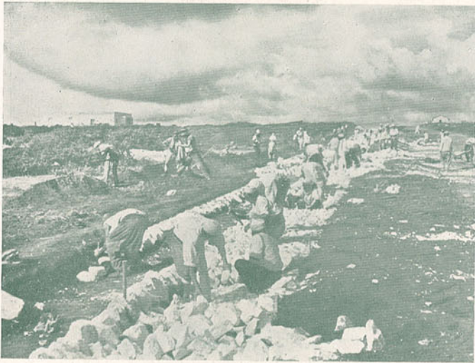
Construção de casas no Gebel Cirenaico que devem hospedar 20 mil colonos italianos que vão desembarcar na Líbia para empreender a grande obra de bonificação
