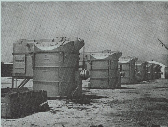
Auto-transformadores de 220/150 kv. destinados à subestação de PEREIROS da C. N. E. depois do desembarque no porto de Lisboa
