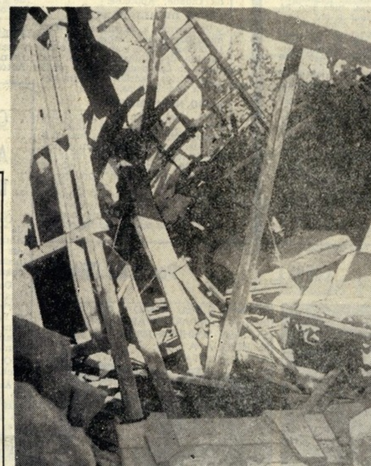
Barrotes, travessas, asnas e tesouras da armação do telhado misturam-se com as pedras do perrecho das paredes do prédio. Esta amalgama de materiais de construção e três feridos são o balanço de uma obra que, parece, não estava a ser executada com os cuidados devidos.
