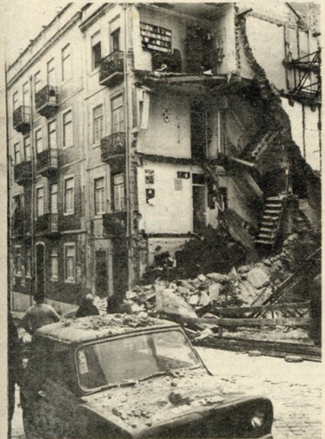
Um prédio ruíu em Lisboa, na Rua dos Açores, ao princípio da madrugada, deixando oito famílias sem casa. Não se registaram acidentes pessoais mas os bombeiros tiveram que intervir para salvar um dos inquilinos. Admite-se que o acidente seja sequência da demolição de um prédio ao lado. Como pode ver-se na imagem, os estragos materiais são consideráveis
