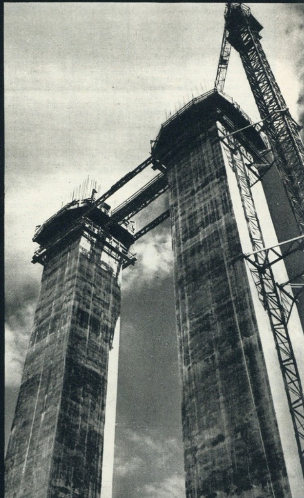
À POUCA E POUCA O LISBOETA OBSERVAVA O CRESCIMENTO DOS PILARES DO VIADUTO
